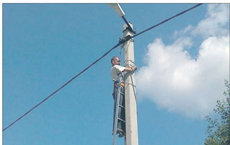
С 2004 по 2010 построена система электроснабжения, включающая 3,5 км высоковольтной линии, 2 трансформаторные подстанции и 9 км внутренних сетей. В 2011 г. организована собственная электротехническая служба по эксплуатации электросетей. Установлена система АСКУЭ автоматического учета потребления электроэнергии по GSM каналам связи
