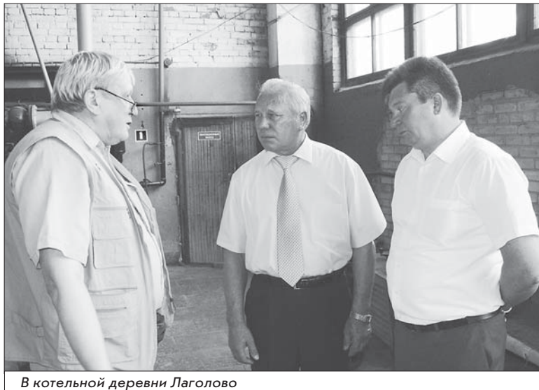
В котельной деревни Лаголово
