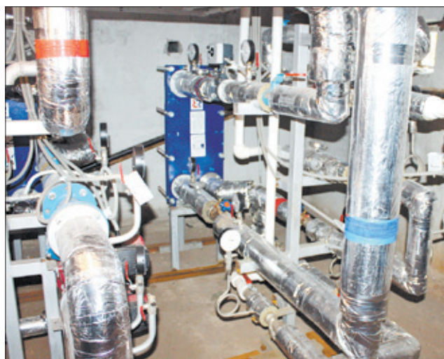
Индивидуальный тепловой пункт жилого дома
