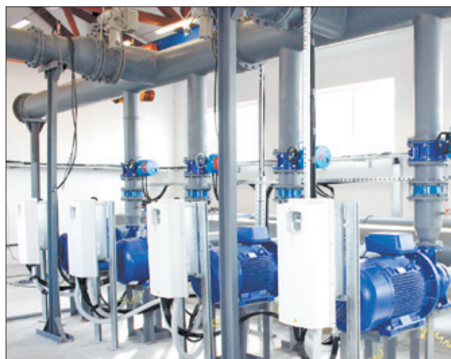
Современное оборудование водонасосной станции
