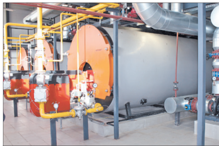
Новая блок-модульная котельная
