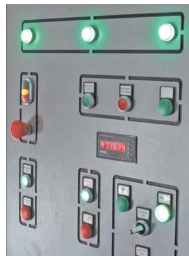
Пульт управления новой линии обработки ТКО
